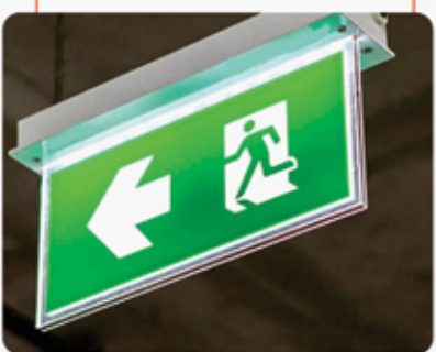
Sistema de Iluminação de Emergência
