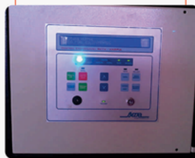
Sistema de Alarme de Incêndio
