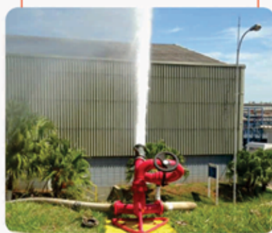
Sistema de Hidrantes
