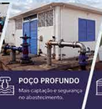
ELEVATÓRIAS Tecnologia e eficiência no saneamento.
