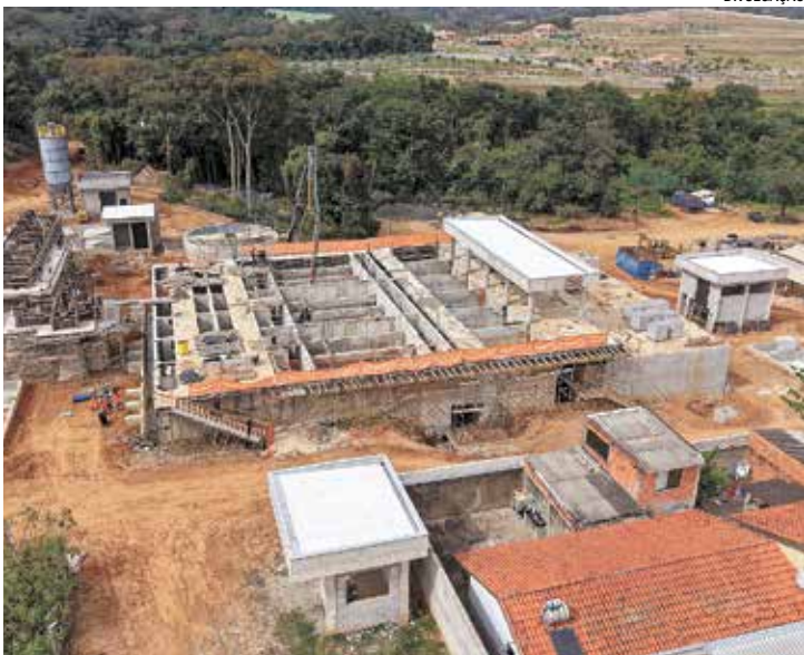
Estação no Tombadouro terá capacidade de tratar 150 litros por segundo
