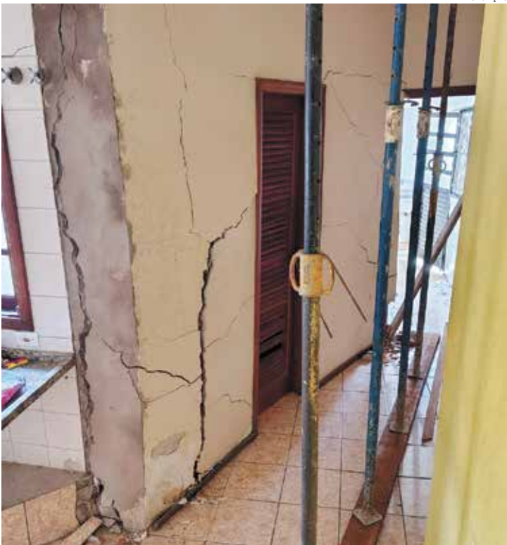
Rachaduras comprometeram a estrutura das quatro casas
