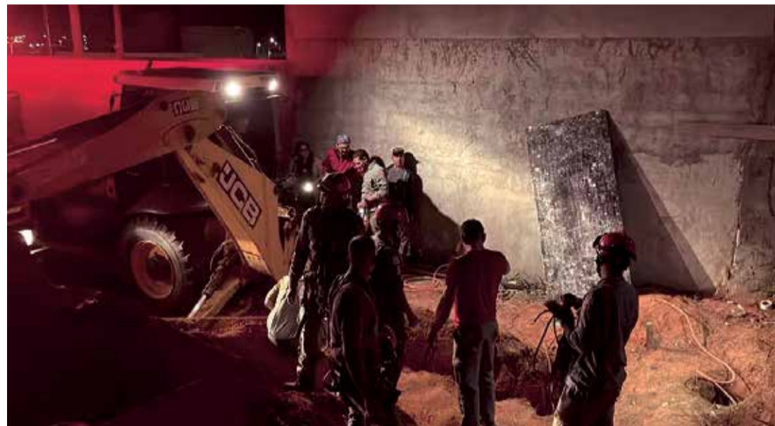
À direita, buraco estreito onde criança caiu em Indaiatuba; à esquerda, vala aberta por bombeiros
