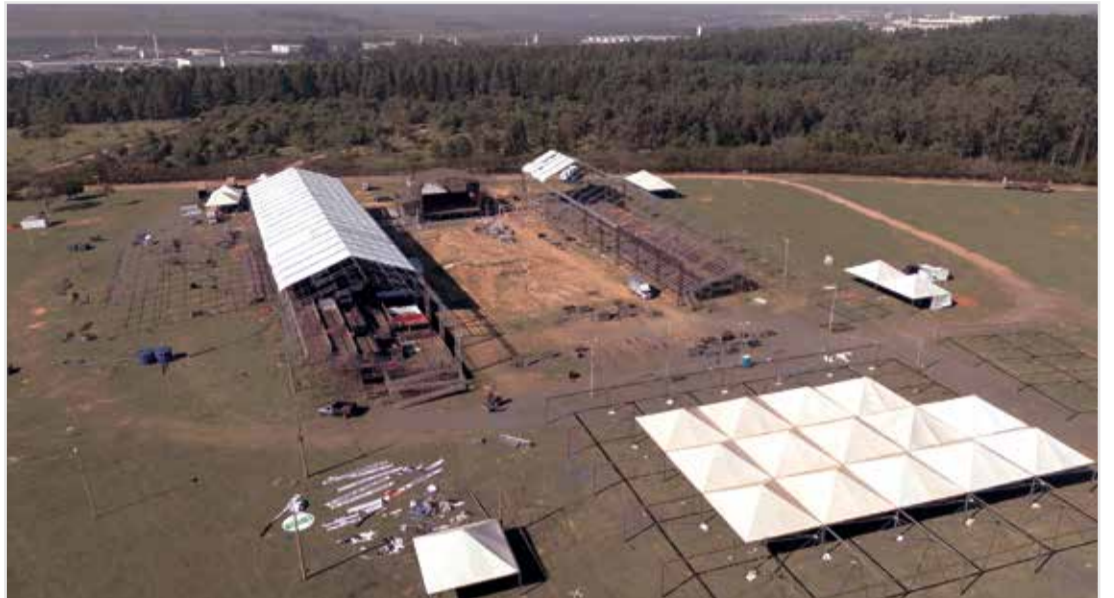
Faltam apenas o acabamento e alguns detalhes para deixar o recinto em condições para receber o público
