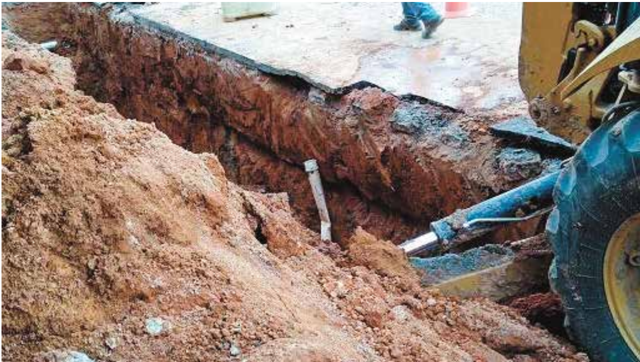
Operário de 43 anos morreu após ser soterrado em obra
